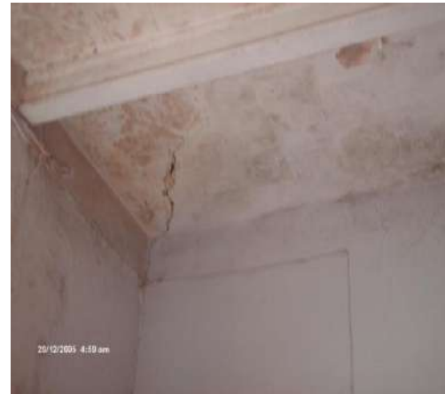
Se aprecia daños en el techo (oficina Titular)
